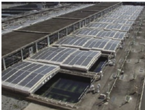
太陽光発電(朝霞浄水場)
